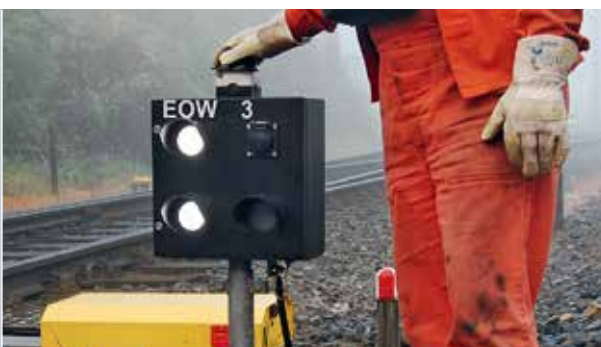
EOW-Anlage RWE Frechen
